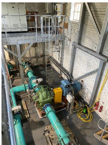
75kW Pump-as-Turbine Installed
